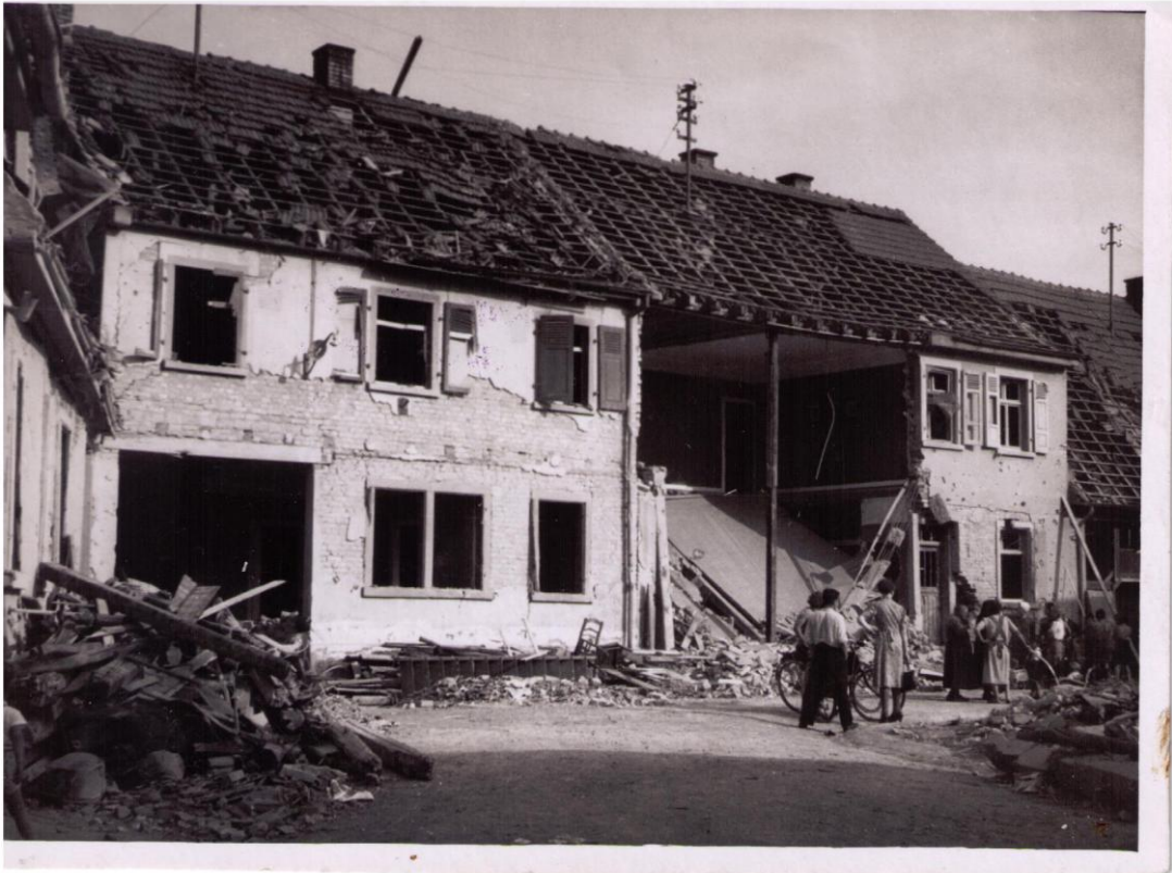
Schadensaufnahme in der Görngasse.
